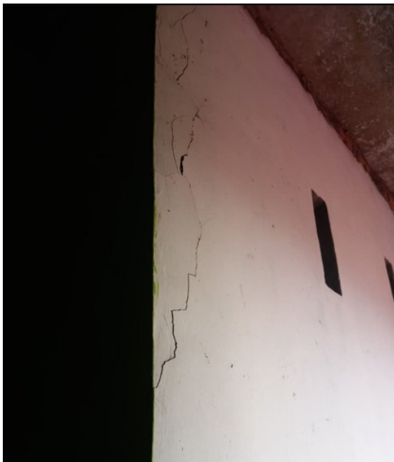
Gambar 2. Retakan yang ada pada dinding bangunan rumah kost
